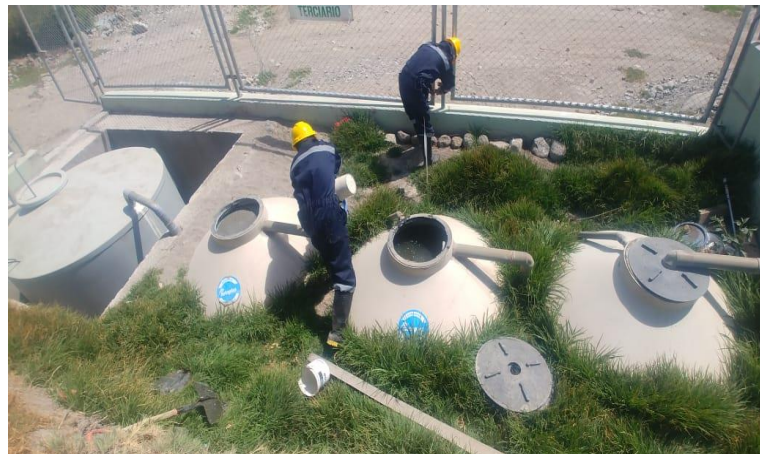
FOTO N° 04 SISTEMA DE FILTRACION: 3 ETAPAS
